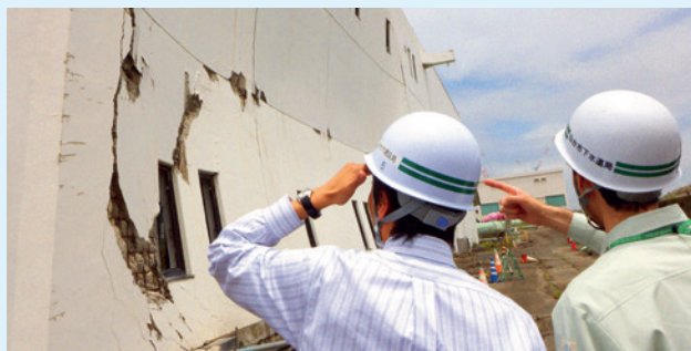
Завод по переработке сточных вод, поврежденный при цунами 2011 года
