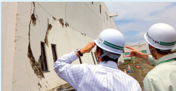
遭到2011年海啸破坏的污水处理厂。
